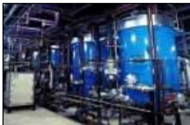
イオン交換樹脂装置
