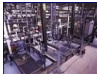
フッ素系排水処理装置
