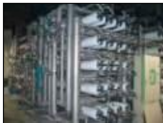
逆浸透膜装置 (RO)
