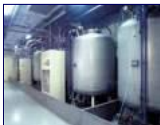
薬液供給システム
