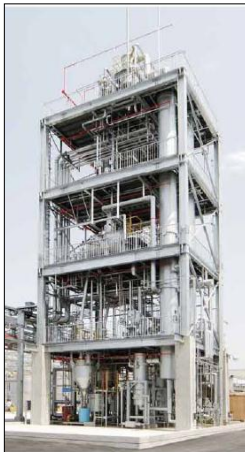
溶剤回収装置
