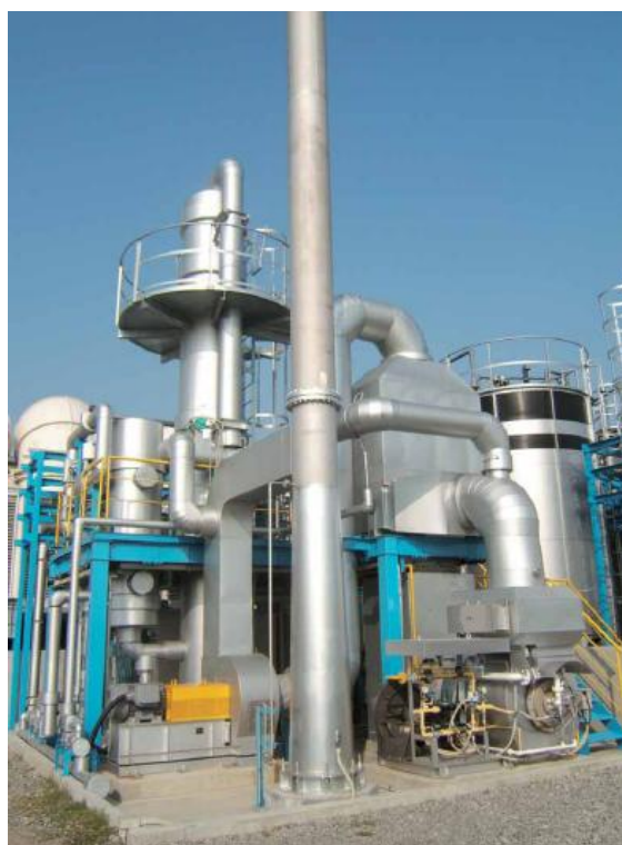
アンモニアガス分解システム
