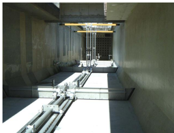
モノレール式汚泥かき寄せ装置
