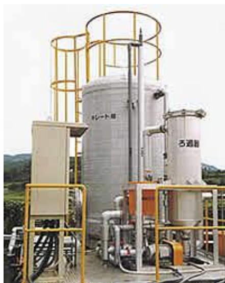
▲排水中の水銀除去設備
